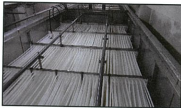
PE儲冰盤管迴路
