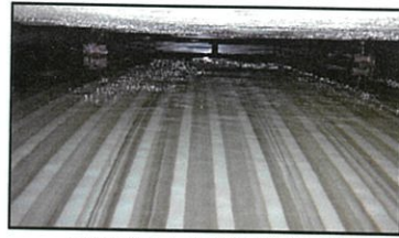
儲冰槽內部盤管結冰
