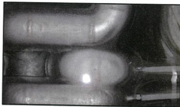
儲冰槽分佈管結冰
